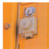
便利な100V電源取出口
